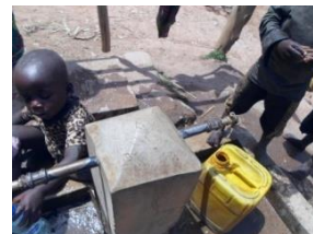
Vandinstallation som ikke fungerer
